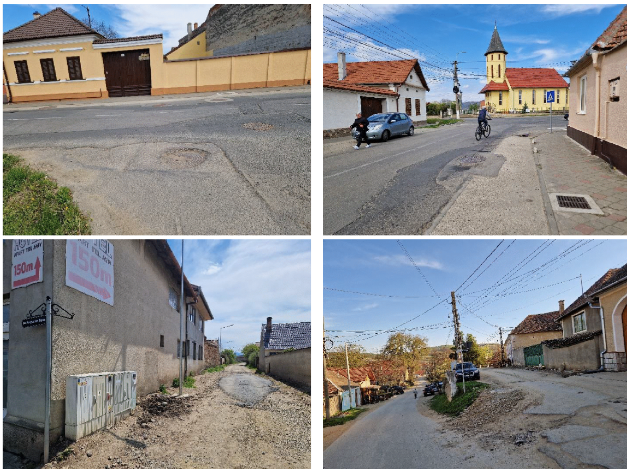
Figura 2.27. Străzi a căror suprafață de rulare se află în stare tehnică necorespunzătoare/neasfaltate.
